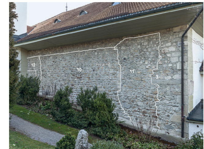
Nordwand der heutigen Kirche. Deutlich zeichnen sich im westlichen Eckbereich Baunähte der Erweiterung (11) und vom Neubau von 1810/11 (3) ab.
